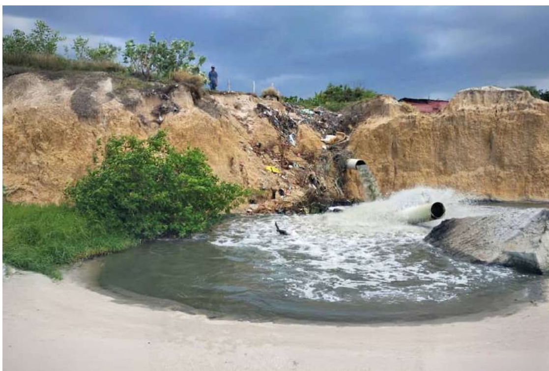
Las descargas provenientes del sistema de alcantarillado distrital superan los límites máximos establecidos en la normativa, explicó Corpoguajira.
